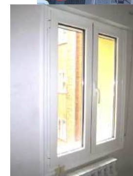
Ventana nueva en habitación
