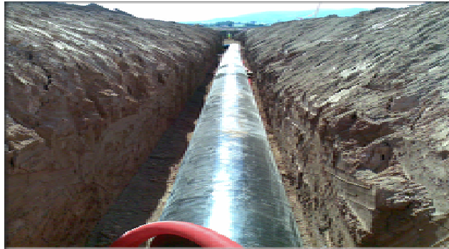
FIGURA nº 4 Tubería de transporte
